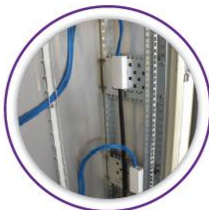
> Arrimages de câbles
